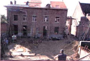
ITTRE - Rue Haute, n° 2 Ancien hospice réhabilité en 3 appartements et 1 crèche Toiture, pose de planchers et finitions.
